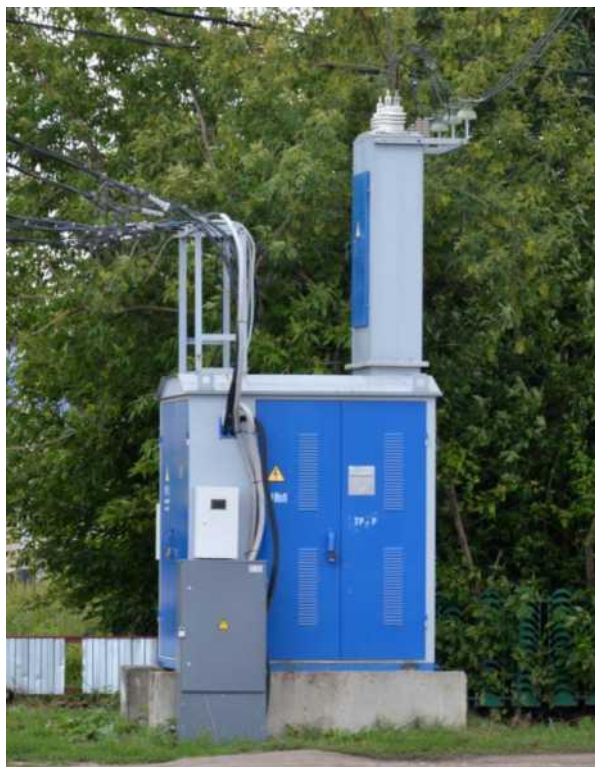
Рис. 15. Село Батырево. Трансформаторная подстанция (фото: АМ «Мой город»)
