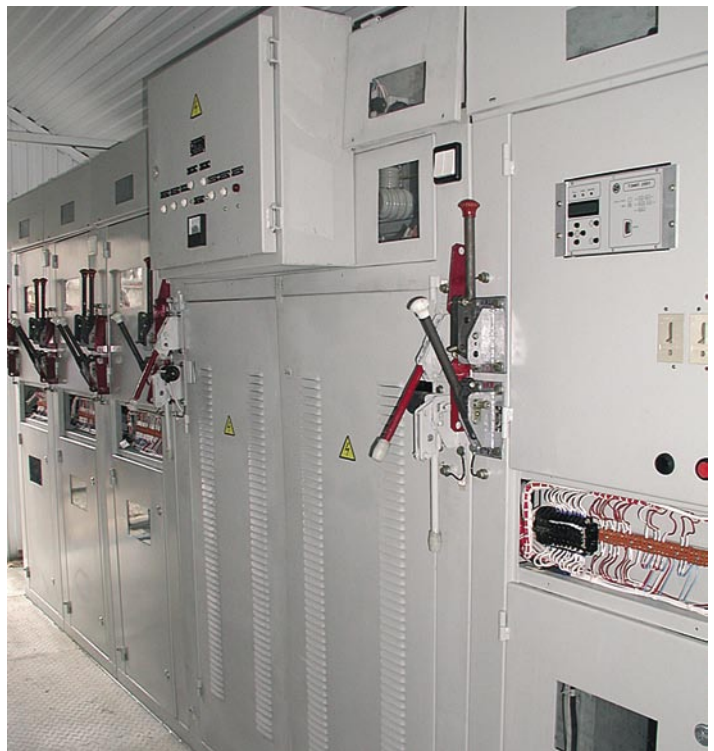
Рис. 2. Элементы системы безударного пуска в блок-боксе
