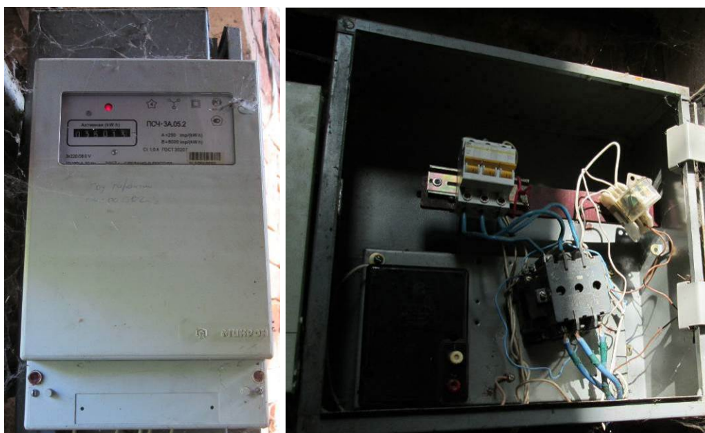
Рис. 1.9. Электрический щит насосной станции СХТ с. Шихазаны
