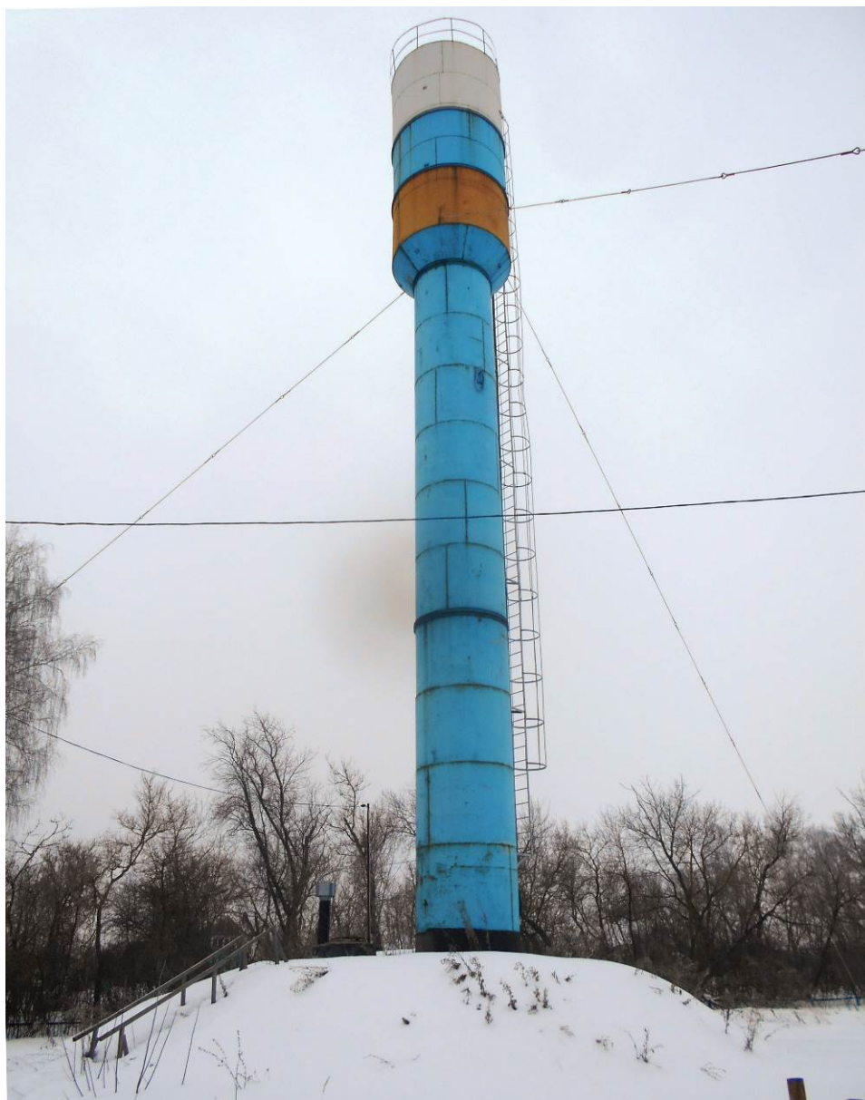
Рис. 1.6. Водонапорная башня по ул. 40 лет Победы от артезианских скважин №1 и №2 с. Шихазаны
