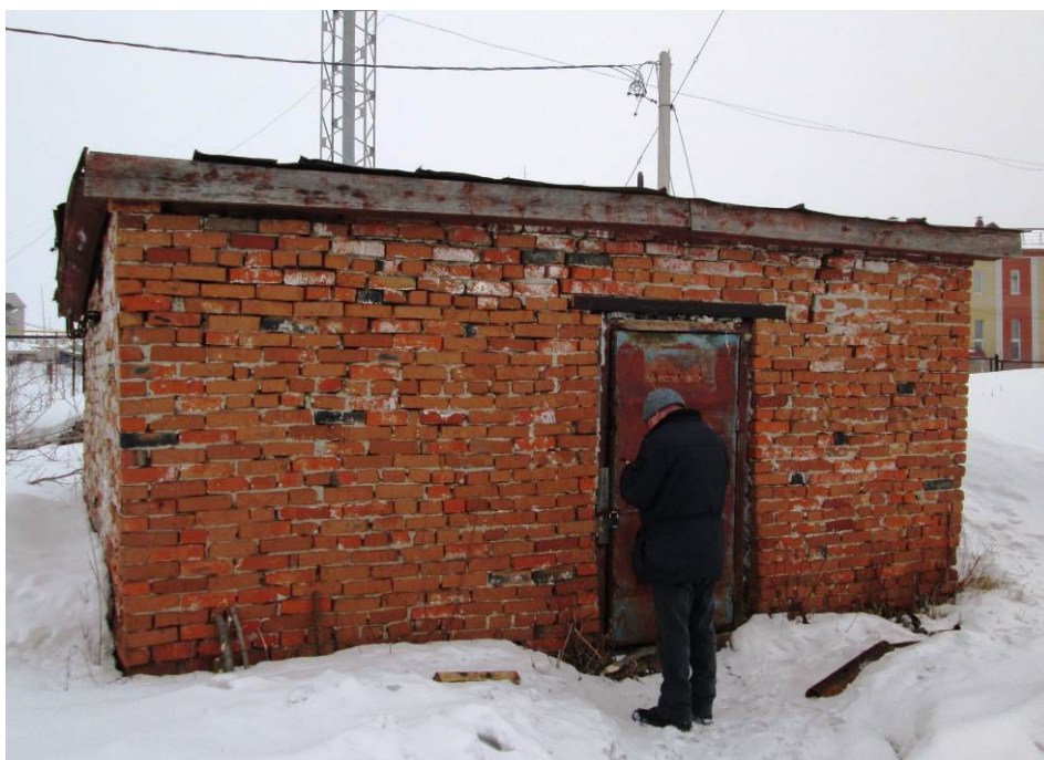
Рис. 1.7. Павильон с электрическим щитом артезианской скважины №3 с. Шихазаны
