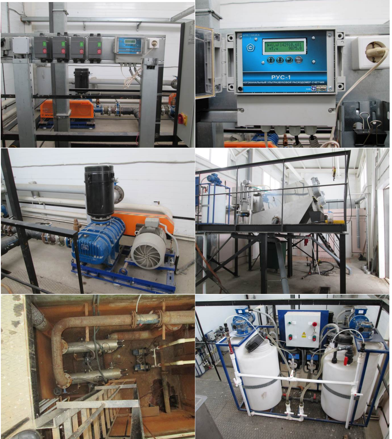
Рис. 1.2. Фотографии оборудования производственно-вспомогательного здания
