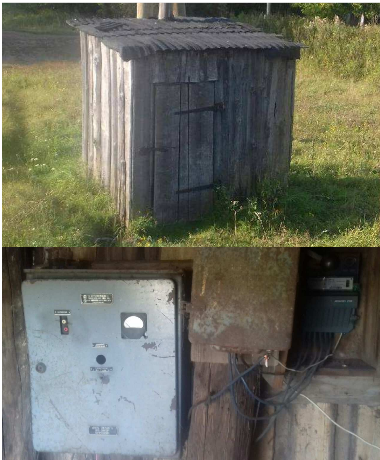
Рис. 1.15. Павильон артезианской скважины и электрический щит д. Ильменкасы
